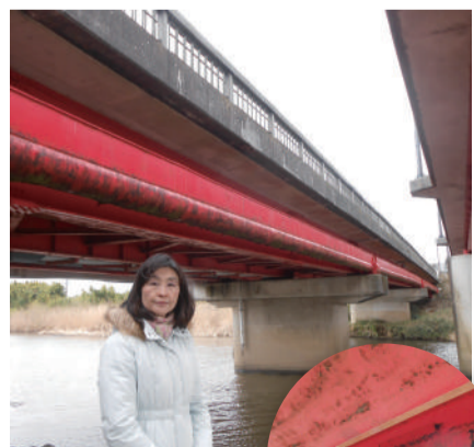
佐倉の東西を結ぶ鹿島橋 腐食が激しい
